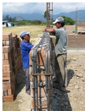
Een glimp van het staal dat verborgen zit in de beton
